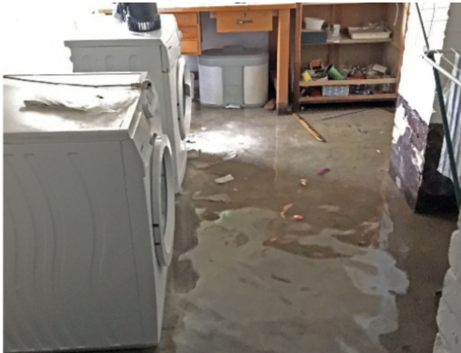
Wasserschaden durch Rohrbruch im Keller
